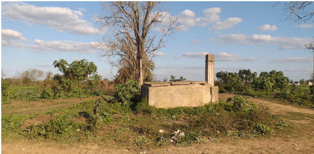
Figura 1 Cámara de ingreso a lagunas existentes.
